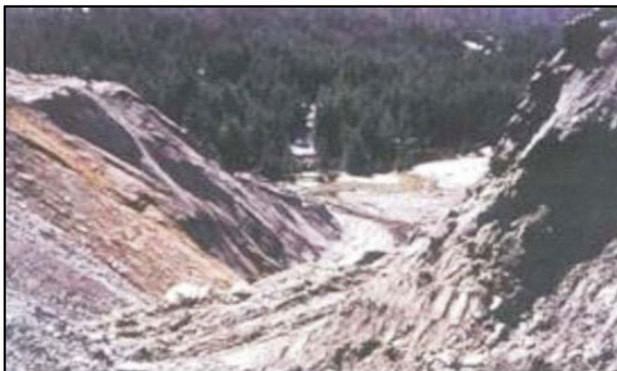
Figura 8. Breșă creată în taluzul iazului de decantare de la Novăț, martie 2000 (sursa foto: Lorber K.E., conform Driga B., Zaharia S., 2010)
